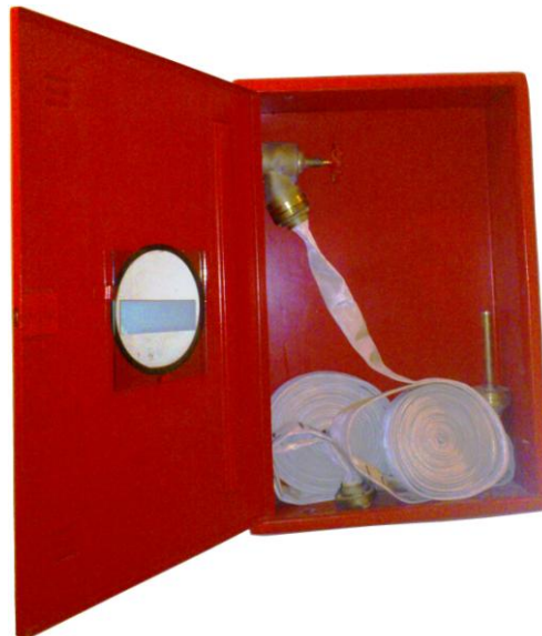
Figura 9 - Hidrante Simples Fonte: Própria
